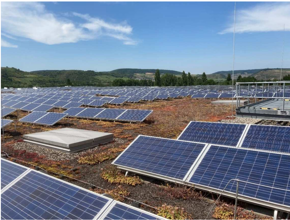
Foto 2: Beispielhafte Darstellung einer extensiven Dachbegrünung in Kombination mit PV-Anlagen (Fotoaufnahme: ÖKOPLANA)
